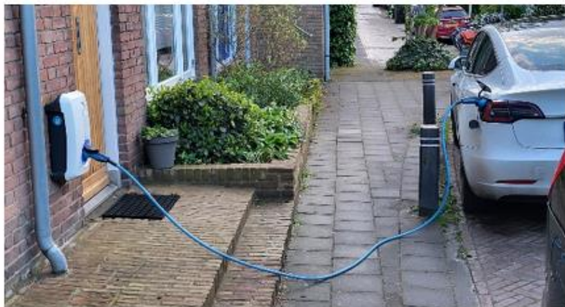
Losliggende ronde kabel
