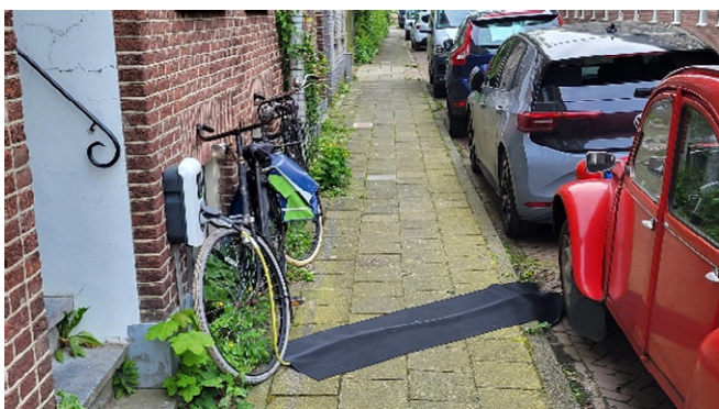
Kabel onder een kabelmat
