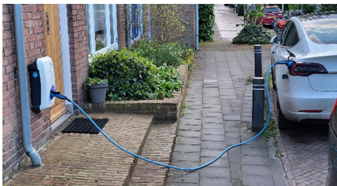
Losliggende ronde kabel
